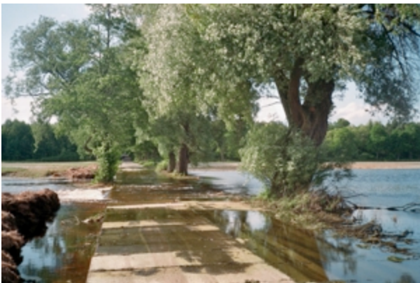
Abbildung 6: Das Hochwasser zerlegt die Betonplattenwege (Foto: H.-J. Grunwald)
