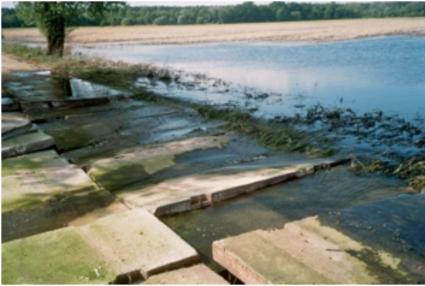
Abbildung 5: Das Hochwasser zerlegt die Betonplattenwege (Foto: H.-J. Grunwald)
